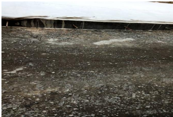
Figure 3.6 Arrachement de la couche de roulement en vue de sa reprise (voie de contournement Alédjo Juin 2018)
