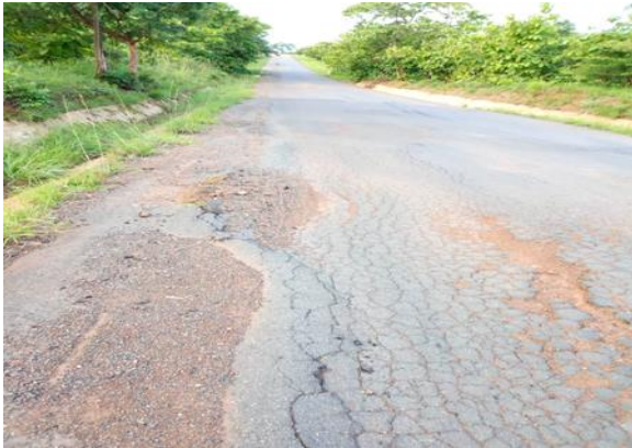
Figure 3.4: Faïençage, désordres généralisés (Juin 2018)
