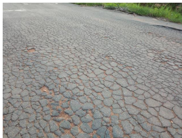
Figure 3.3 : Faïençage significatif très avancé (Juin 2018)
