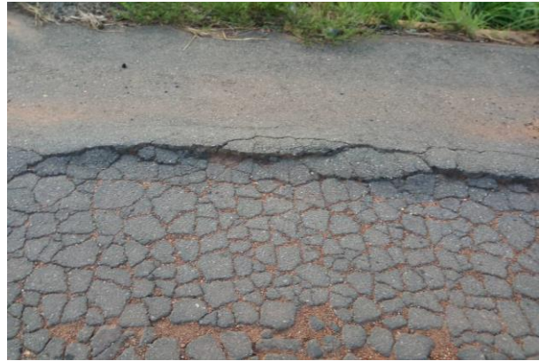
Figure 3.5: Faïençage très avancé accompagné d'une dépression (Juin 2018)
