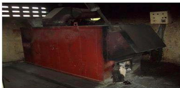
Photo 15 : Four de l'incinérateur électrique. Source : Cliché de DEGUENON, 2011
