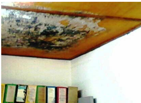
Vue partielle du plafond indiquant un point d'infiltration d'eau dans le magasin du SDAI.
