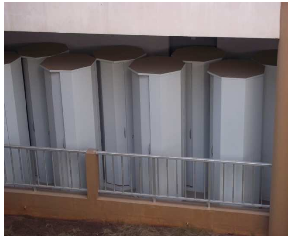
Photo n°5 : armoires exposées à l'air libre
