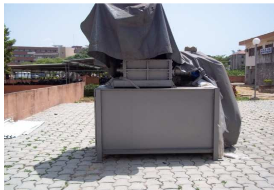
Photo n° 3 : Broyeur exposé à l'air libre et à toutes sortes d'intempéries
