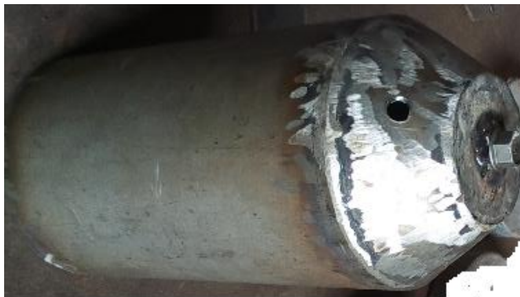
Figure 2.3. : Générateur de vapeur
