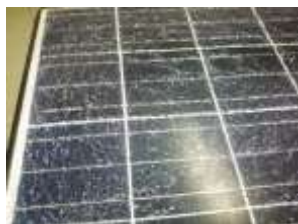
Figure 15: Module photovoltaïque présentant des bris de verre
