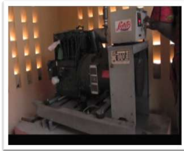
Photo no 4 : le groupe électrogène de marque lister du réseau d'adduction d'eau potable
