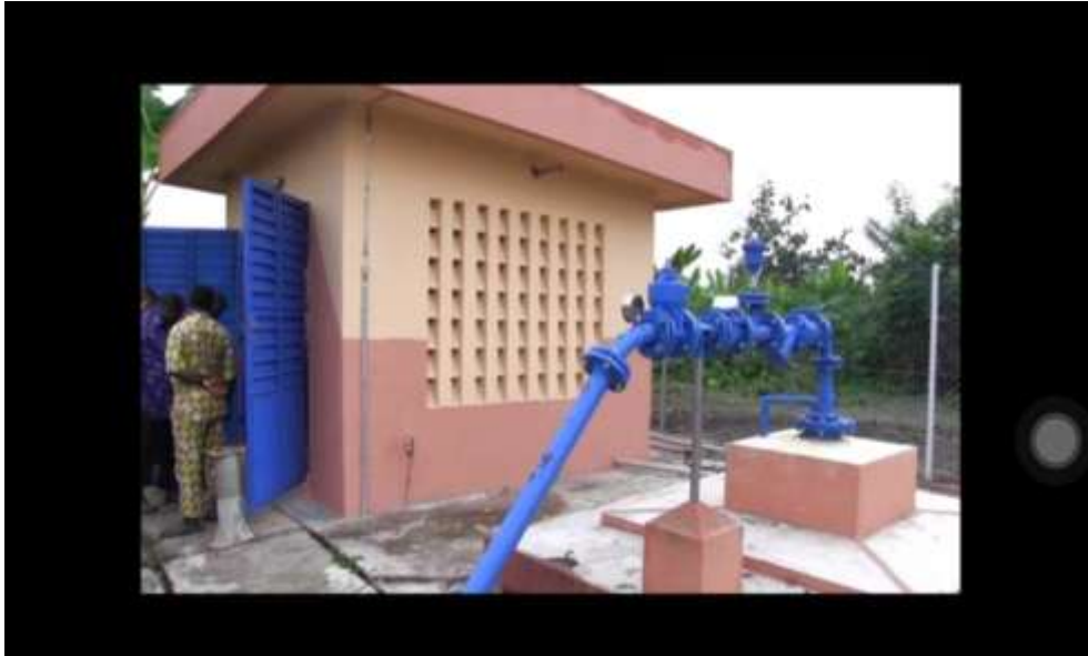
Photo 3 : la pompe électrique du réseau d'adduction d'eau potable
