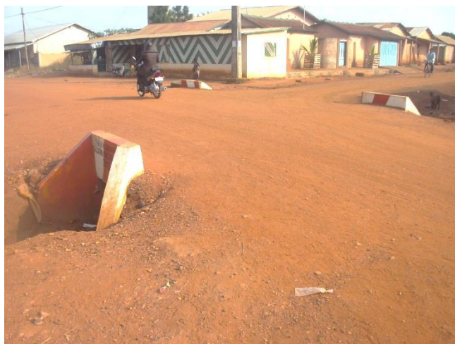
Photo 7 : Construction de dalots sur la voie Klouékanmè-centre-Djotto Prise de vue : Etou, août 2016
