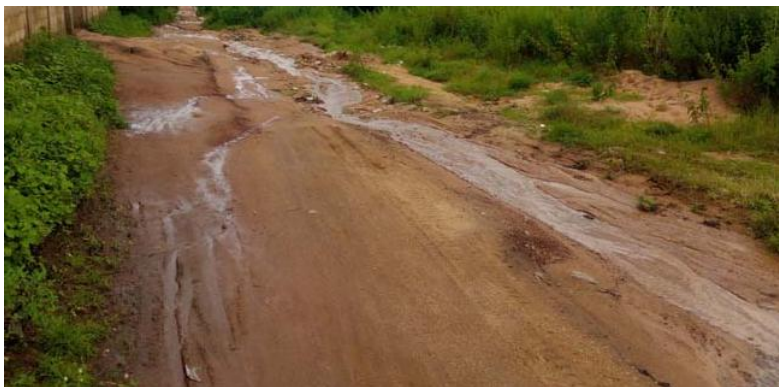
Photo 3 : La voie Kilibo-Nigeria dans un état de dégradation
