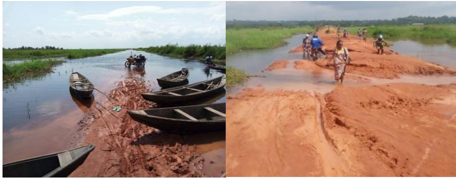
Planche 3: voie inondée et dégradée à Tovè (Arrondissement de Kessounou)
