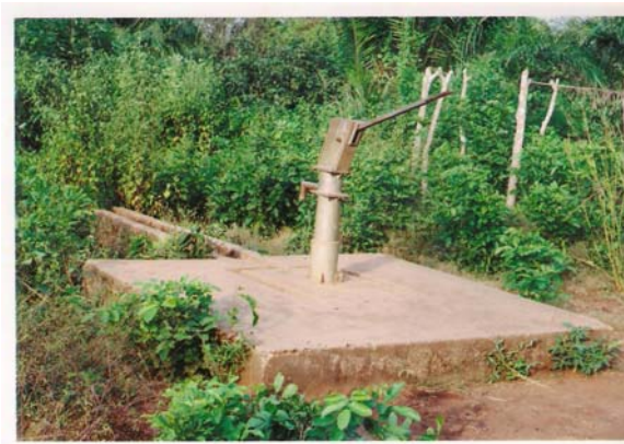
Photo n°9 : FPM en panne à Hèkanmè
