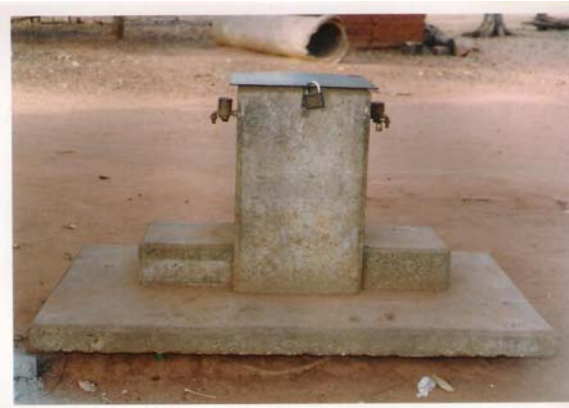
Photo n°5 : Pompe de la SONEB à Gbovié en panne
