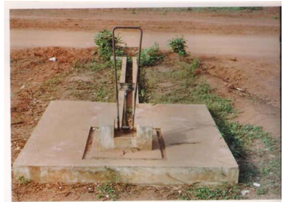
Photo n°8 : FPM en panne à EPP Accadjamè
