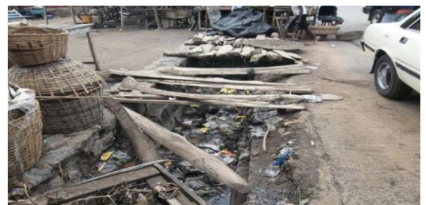
Photo 5 : Caniveau insalubre au marché central de Glazoué
