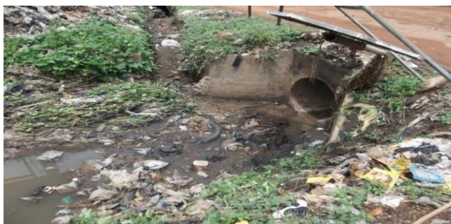
Photo 4 : Insalubrité au niveau d'un dalot à proximité du Centre de Glazoué
