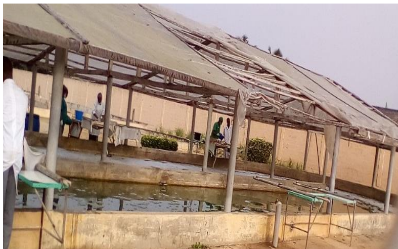
Figure 4: Vue d'un bassin
