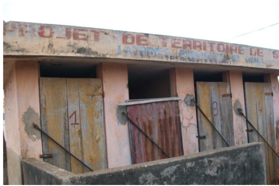
Photo 4.1a : vue partielle d'une latrine en état de dégradation au marché d'obada arrondissement de Boni.
