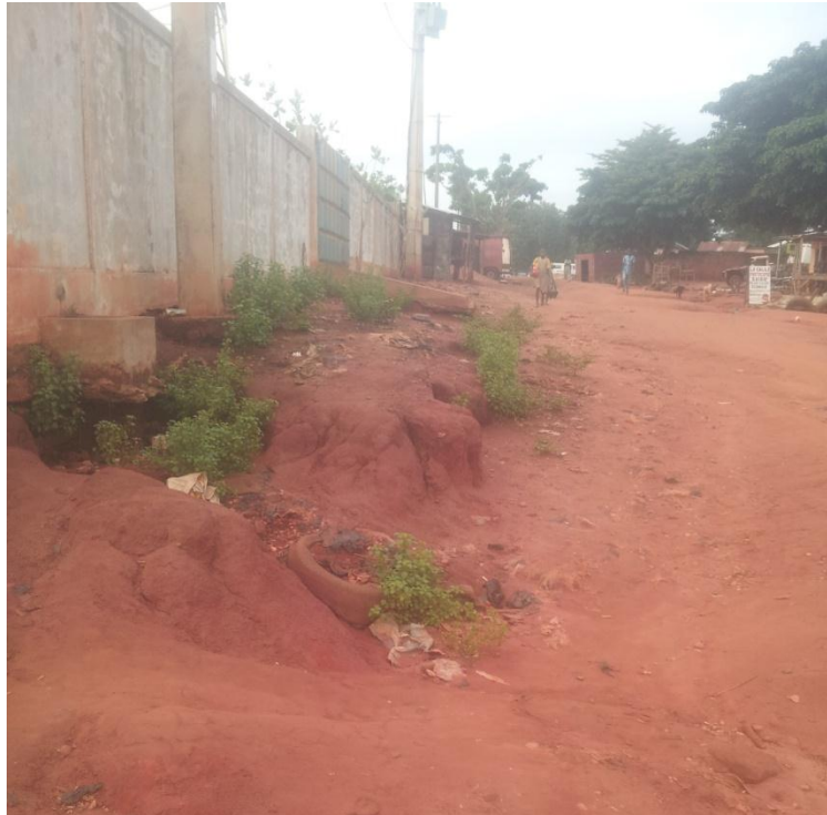
Photo 6: Vue partielle d'une voie en pleine dégradation avancée dans le quartier de ville de Djimadohoué
