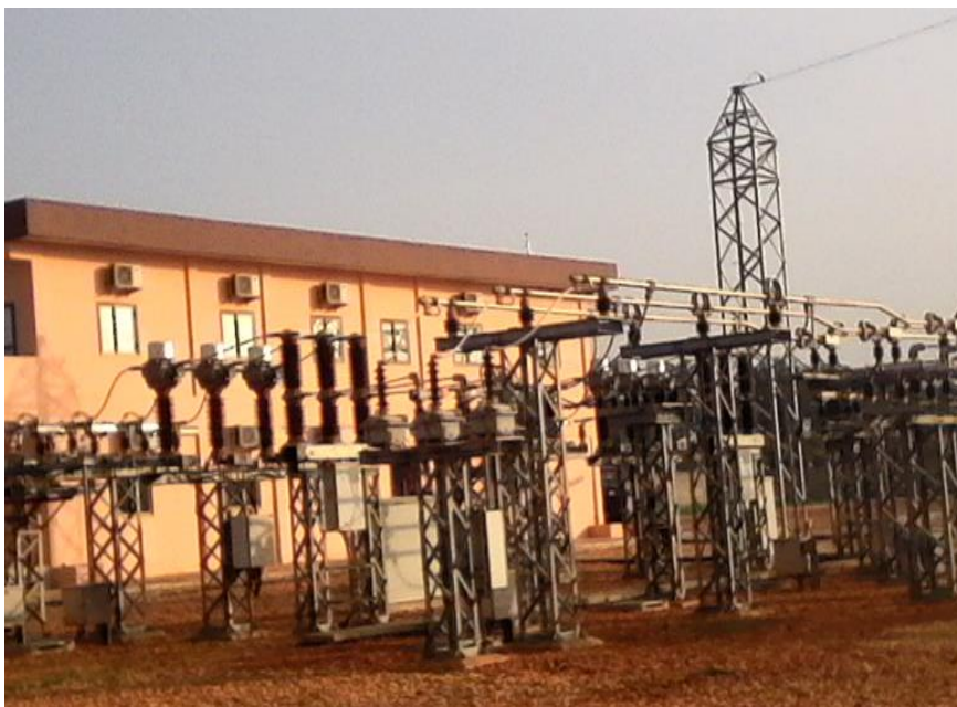
Photo 1: Vue partielle de la centrale électrique (CEB) à Odanrégoun
