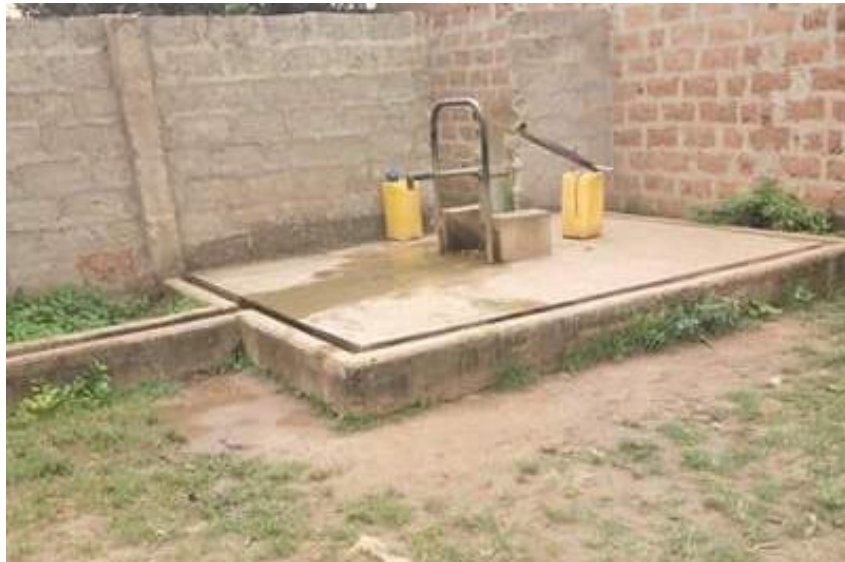
Photo 1 : Forages équipés de Pompes à Motricités humaines FPM à Zoukou Prise de vue : Anato, Juillet 2017
