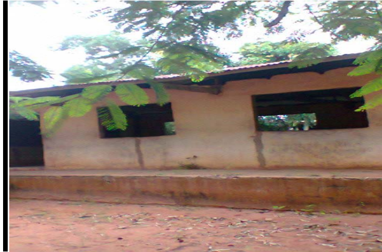
Photo1 : Etat du bloc "G".
