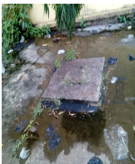
Photo 3 : Eau stagnante au Lycée Béhanzin
