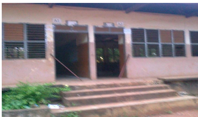
Photo 3 : deux salles de cours sans portes
