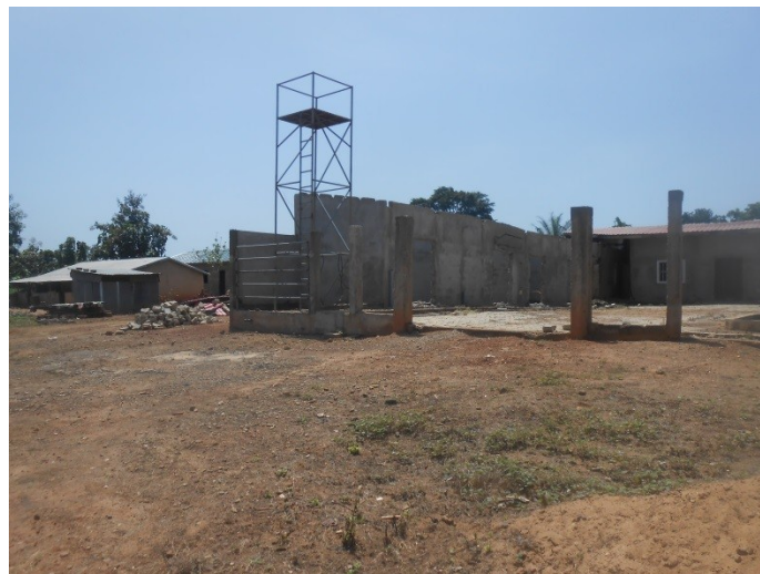
Photo 8 : Destruction de bâtiment Pia Market à Adjantè Prise de vue : Assogba, mars 2016
