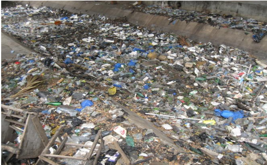
Photo 4 : collecteurs d'eaux pluviales remplis de déchets ménagers à Dantokpa (6 e arrondissement)
