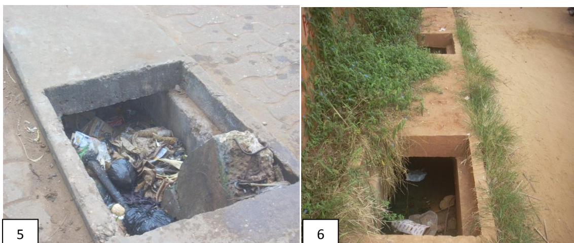
Photo 5 et 6 : Etat des caniveaux à Ouidah I
