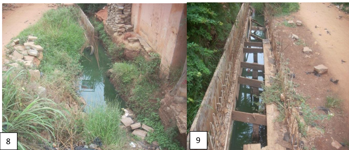
Photo 8 et Photo 9 : Vue partielle des caniveaux qui longent les voies à tovè et fonsramè
