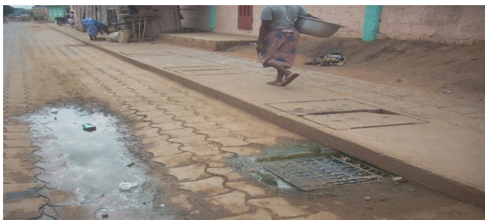
Photo 7: Stagnation d'eau usée sur la voie payée à Ouidah I
