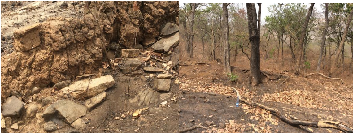
Planche 4 : Muraille en terre battue et tranchée fortement dégradées sous le poids des intempéries naturelles
