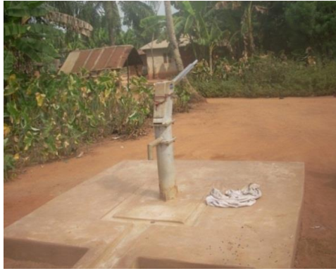
Photo 7 : Pompe à motricité humaine à Houssoussa (Arrondissement de Tangbo) Cette pompe motrice est en panne Source : Cliché Ehoulo, 2012
