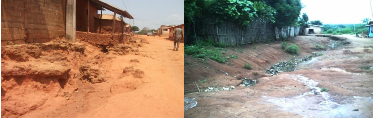
Photo 8: Rue ravinée sous l'effet du ruissellement à Ouèdèmè-Pédah et Djacôté
