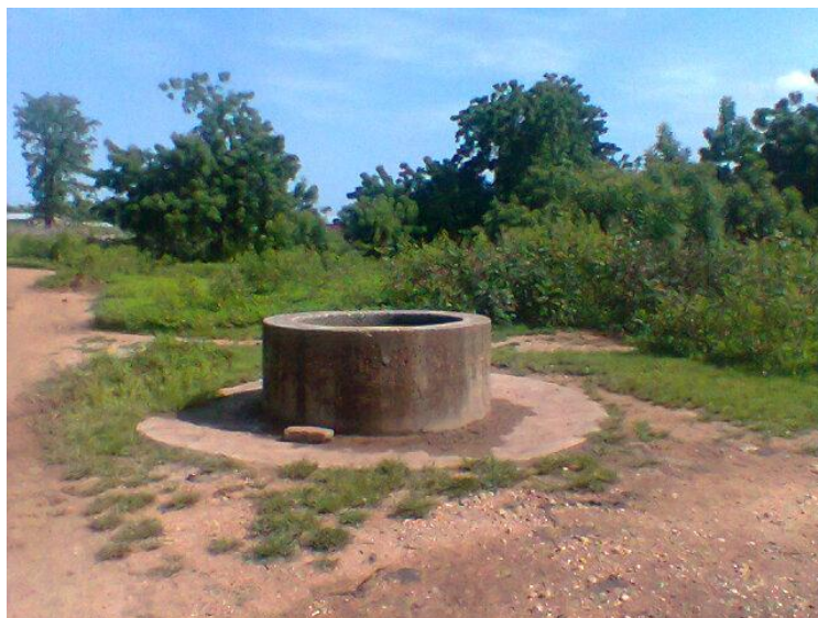
Photo 1 : Puits non couvert Prise de vue : Daba, septembre 2014
