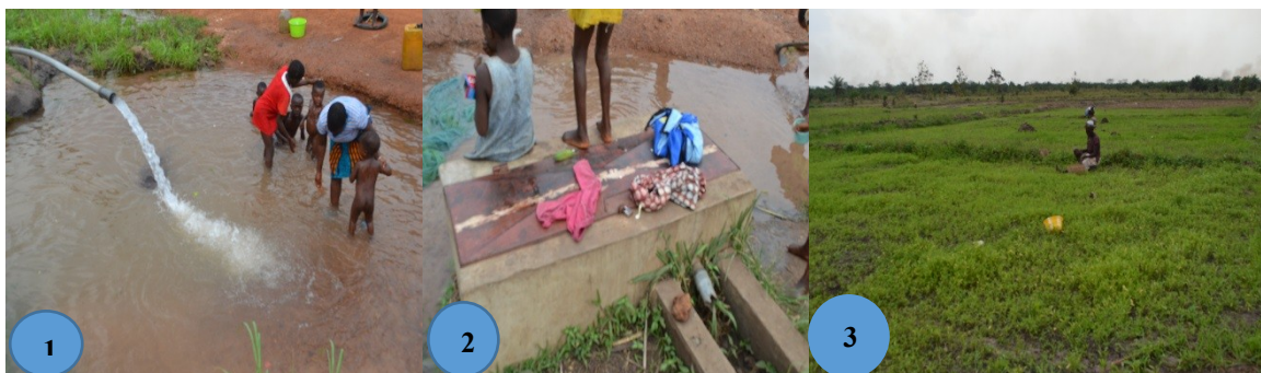
Photo 13 : 1. Trop plein du forage artésien de Tinou-Hounsa déversé dans la nature ; 2. Réalisation d'un système de drainage de l'eau gaspillée à travers les tuyaux PVC vers le périmètre rizicole aménagé ; 3. Périmètre rizicole aménagé transformé en espace de culture de crinclin.
