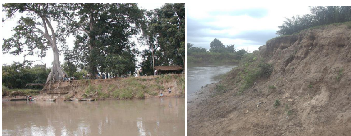
Photo 21: Erosion des berges menaçant de chute le kapokier Photo 22: Etat érosif des berges du fleuve Mono
