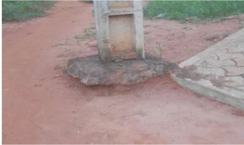
Photo 24: Dégradation du poteau électrique par l'érosion hydrique à Vakon Prise de vues : Avocèvou, mars 2017
