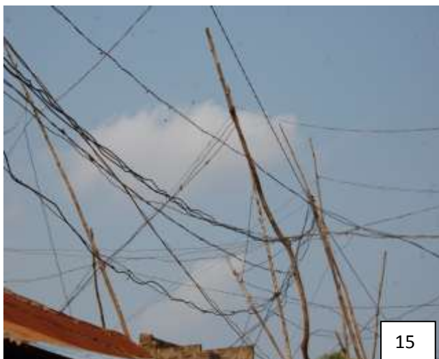
Photo 15 : Branchement de l'énergie électrique appelé "toiles d'araignées"
