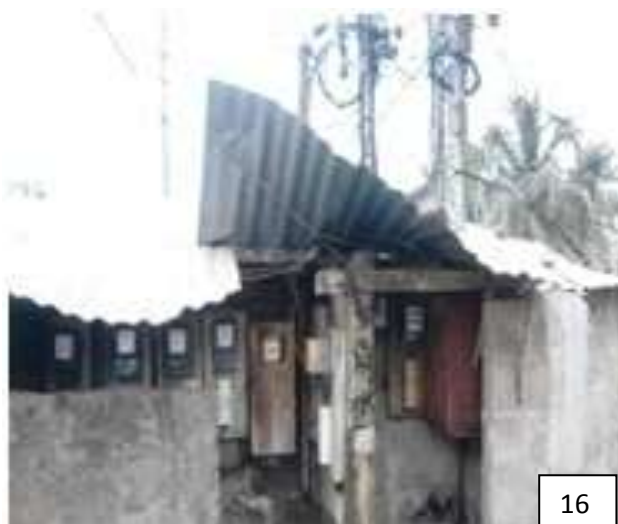
Photo 16 : cabines d'installation des compteurs électriques à Abogomé
