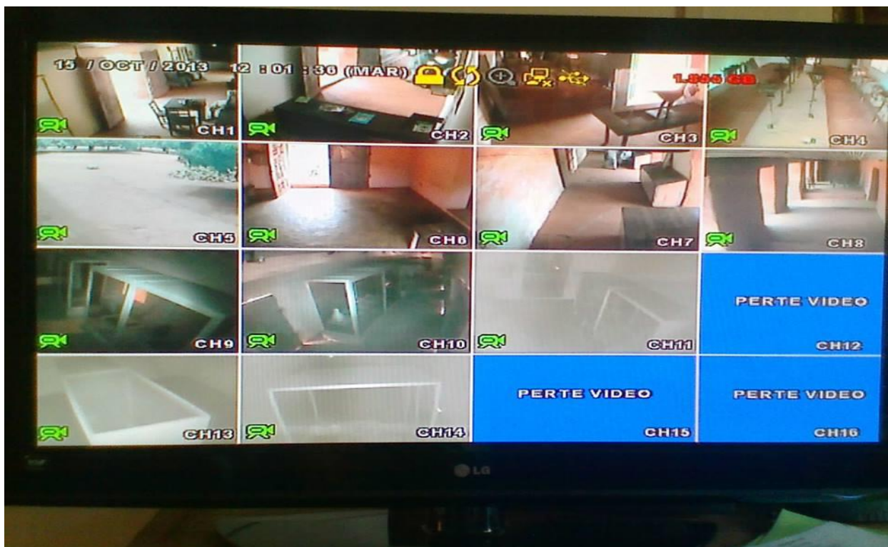
Fig.3 : Poste central de sécurité actuel du site des Palais Royaux d'Abomey
