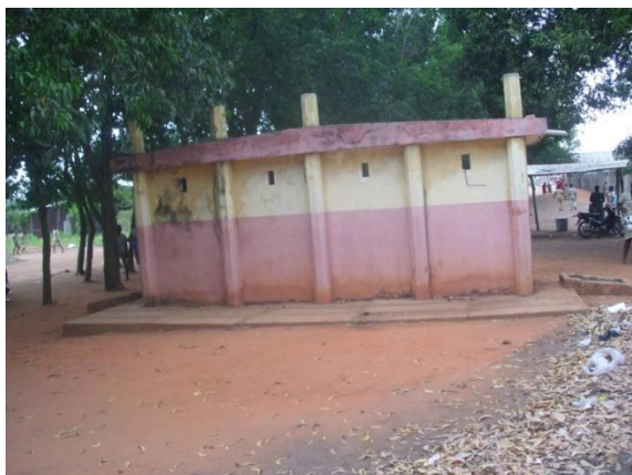
Photo 20 : Latrines à trois isoloirs vues de dos
