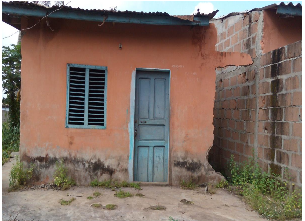
Bâtiment perdu par son propriétaire après recasement: Photo 2015
