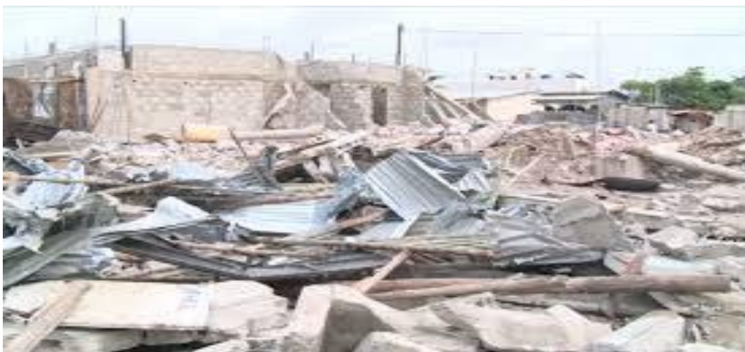
Maison démolie après décision de justice : Photo 2015
