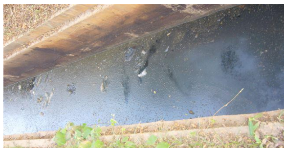
Photo 1: Etat insalubre d'un caniveau au Camp-Adagbè
