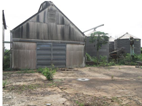
Photo11 : Rizerie de Mitro vue de l'intérieur en état de ruine.
