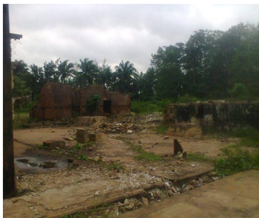
Photo 9 : Huilerie de Gbada vue de l'intérieur en état de ruine
