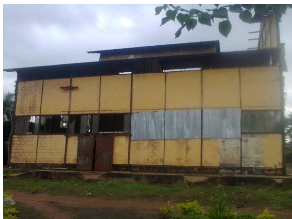
Photo 8 : Huilerie de Gbada vue de façade en état de ruine
