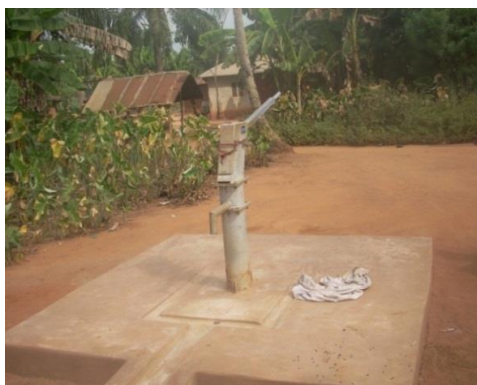
Photo 7 : Pompe à motricité humaine à Houssoussa (Arrondissement de Tangbo) Cette pompe motrice est en panne Source : Cliché Ehoulo, 2012
