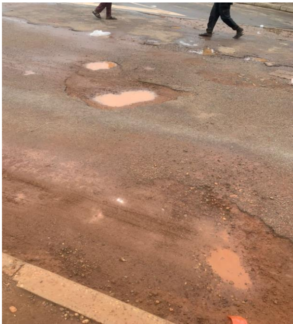
Photo C : Epaufrure au niveau du carrefour du marché, côté gauche, sens Mairie Lokossa-INSTI Lokossa
