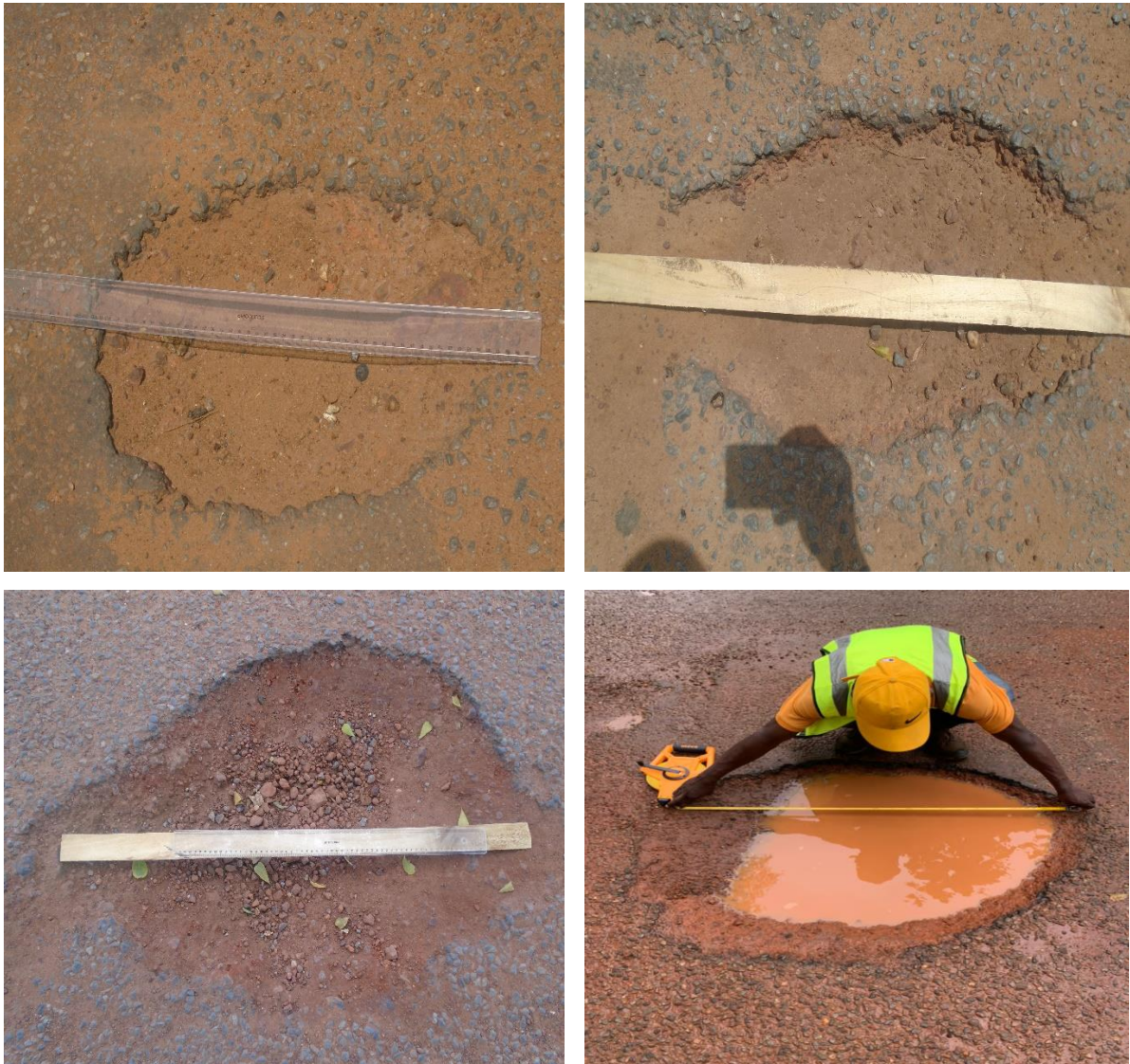
Photo A : Nids-de-poule en pleine chaussée
