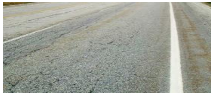
Photo 6 : Vieillesse de la chaussée [11]
