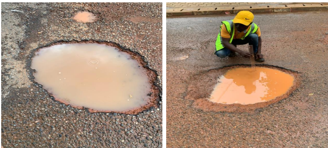
a) Nids-de-poule au PK0+150 côté droit (à côté de la clôture du CEG 1 Lokossa)
