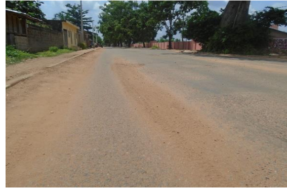
d) Ornière au PK1+730 côté gauche, sens Mairie-INSTI Lokossa
