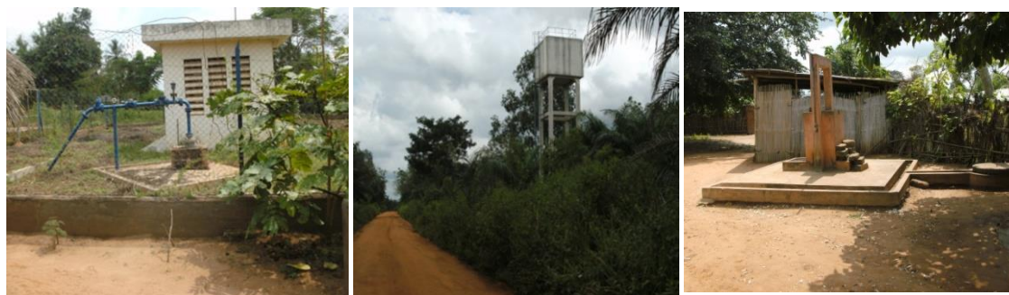
Planche 9 : Le système d'Adduction d'Eau Villageoise de Gbédji (arrondissement de Sè) Prise de vue : KPEHOUNOU , Septembre 2014
