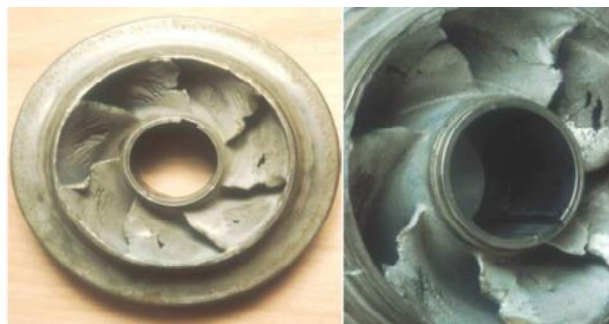
FIGURE 7: PHOTO DU ROTOR D'UNE POMPE ENDOMMAGÉE
