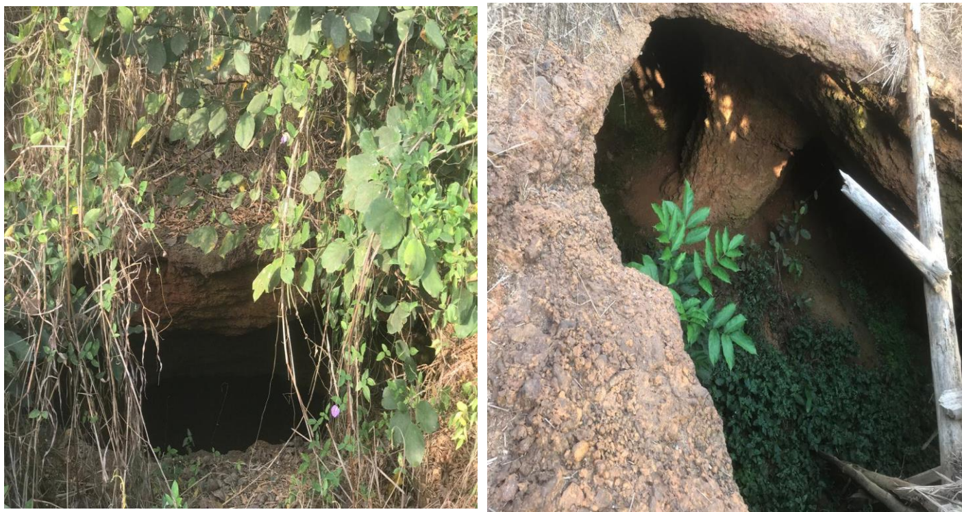
Image n°3 : Entrées souterraines herbeux et dégradées
