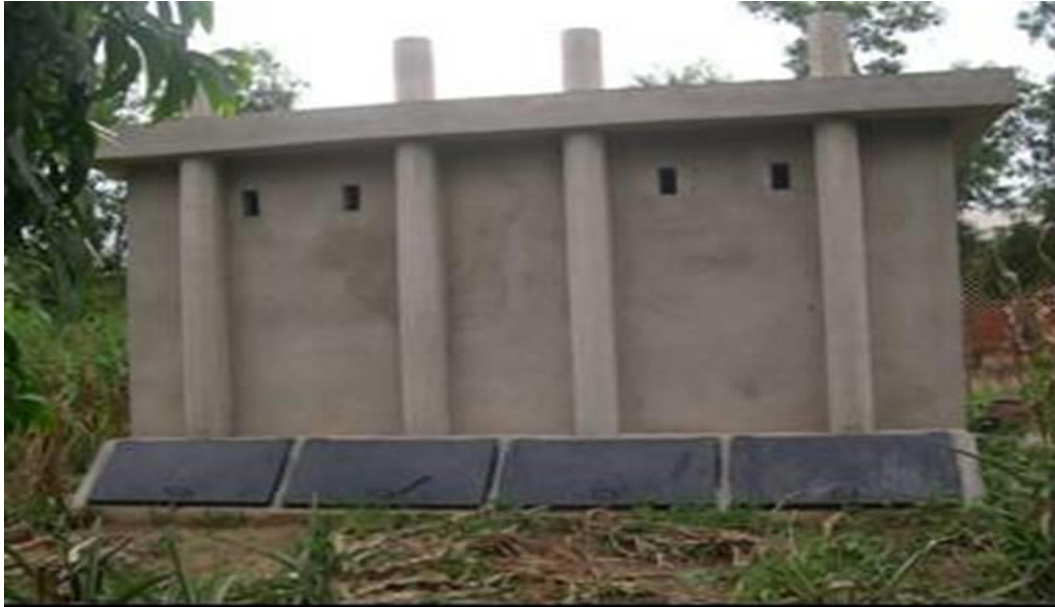
Photo n °7: Latrines EcoSAN à 4 fosses et à double cabine
