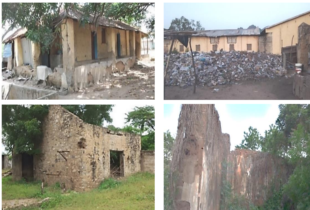
Photo 26 : Quelques images montrant le mauvais état de conservation des bâtis coloniaux
