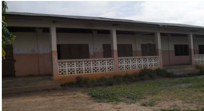
Photo N°17 : Une salle de classe construite en 2007 au CEG de Ouassougou dans l'arrondissement d'Akiza (ZOGBODOMEY) présentant en moins de cinq ans des fissures.
