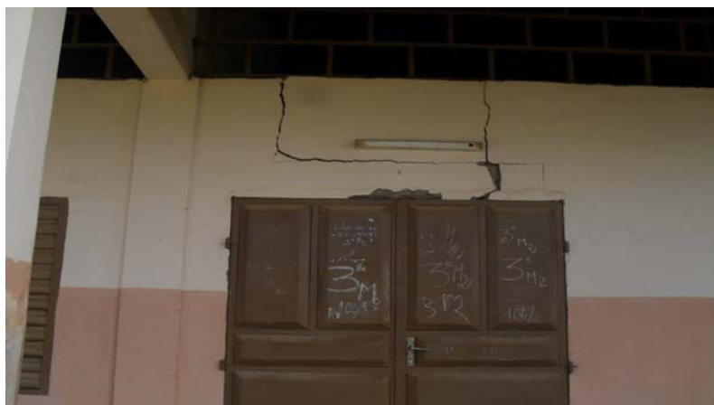
Photo N°18 : La fissure constatée après cinq (05) ans exposant les usagers au risque d'effondrement et autres dommages (Problème de manque de suivi des chantiers et autres).
