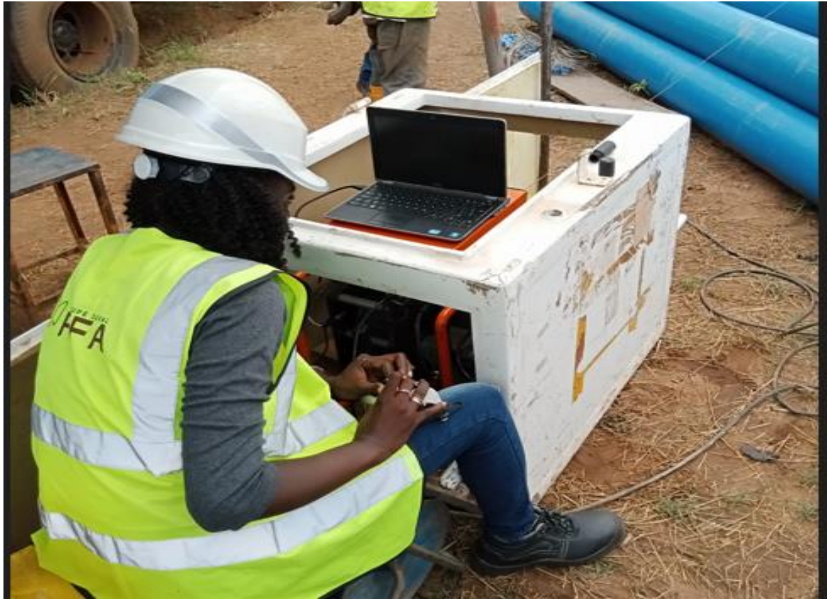
Photo 7: Poste de commande
