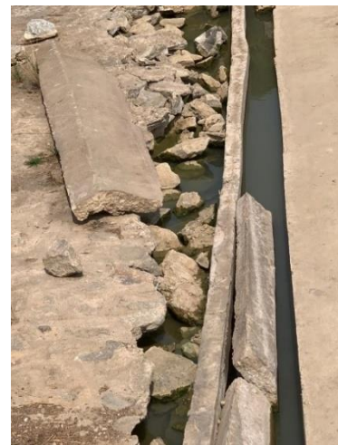
Photo 4 : Bassin de dissipation dégradé
