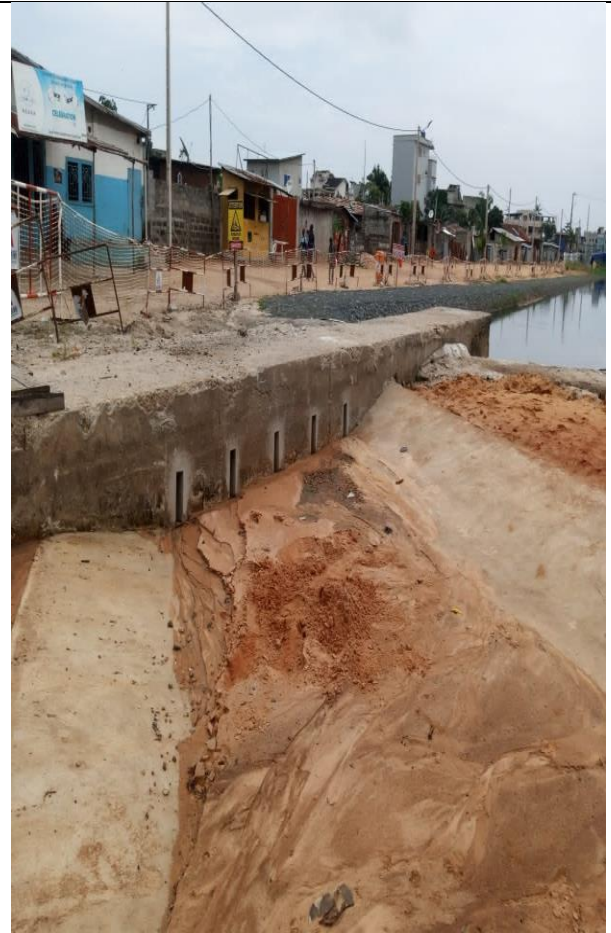
Photo 2 : Rigoles connectées au collecteur de drainage des eaux pluviales
